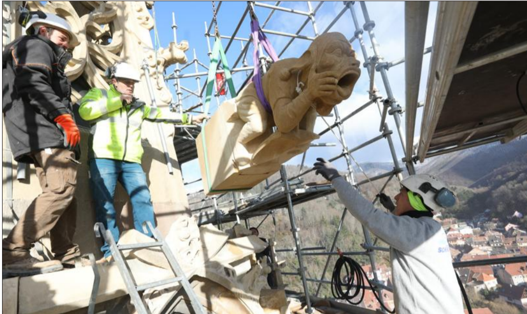
Le retour au bercail du fou du roi, glissé par la grue entre l'échafaudage et la flèche de la collégiale.
