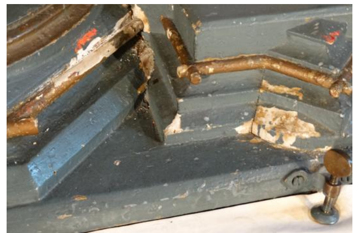
Les boiseries sont dégradées.
